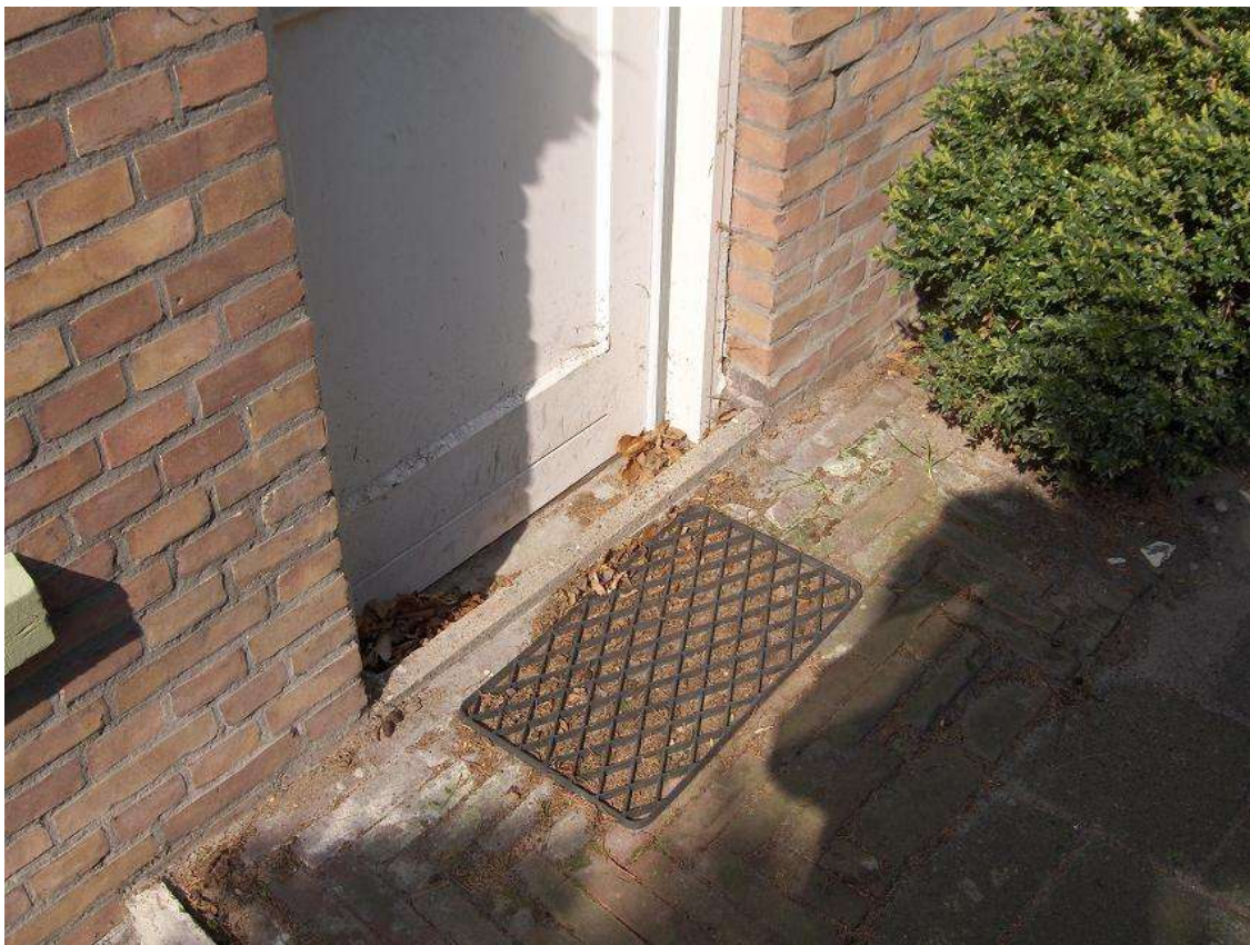
De begane grondvloer ligt lager dan het verlaagde gedeelte in de straat.
